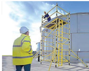
Manutenção em Refinarias , classificadas como Zona 1 Cores de grande visibilidade
