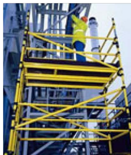
Segurança e acesso simples nas instalações mais complexas
