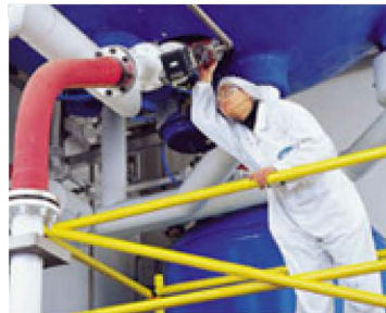
Manutenção em Refinarias , classificadas como Zona 1 , confere proteção contra riscos de explosão
